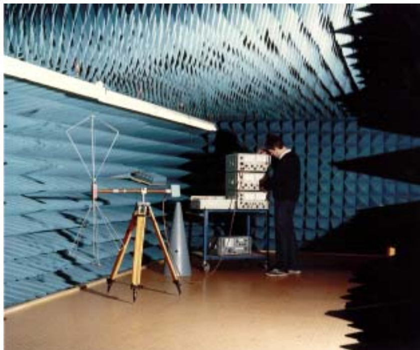
Bild: EMV Absorberraum mit Pyramiden-Absorbern
